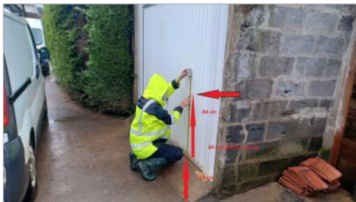
Laisse de crue à 96 cm/sol.
