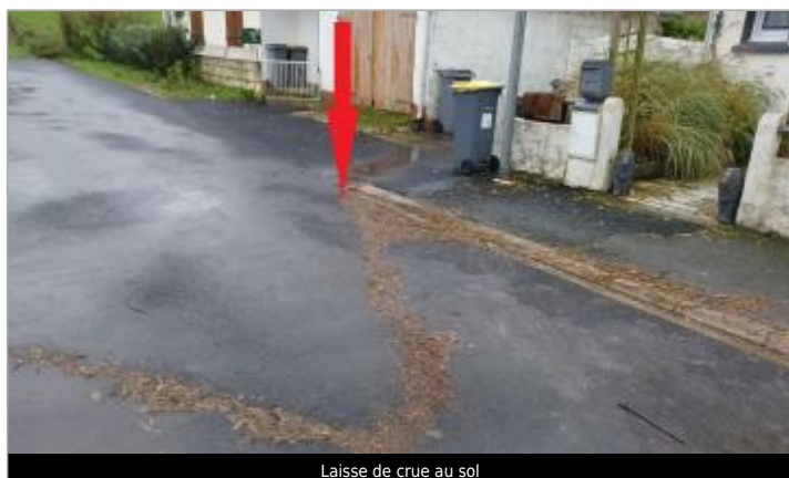
Laisse de crue au sol
