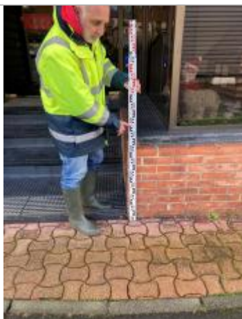
repere de crue mesuré au droit du muret (sur la base d'un témoignage)
