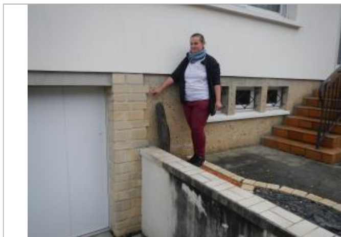
repere de crue sur le mur à droite de la porte de garage
