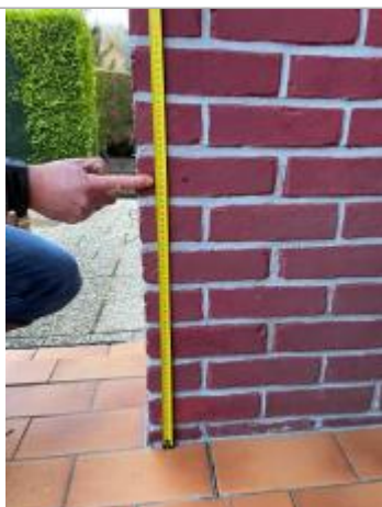
repere de crue sur le mur à gauche de la porte d'entrée
