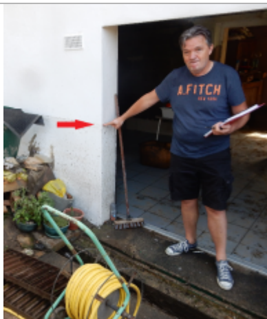
Niveau visible sur façade à 114 cm/sol
