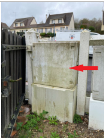
Niveau sur compteur électrique
