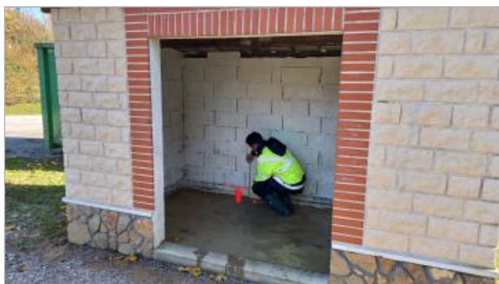
Laisse de crue à l'intérieur de l'abri bus.
