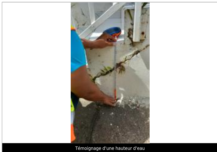
Témoignage d'une hauteur d'eau
