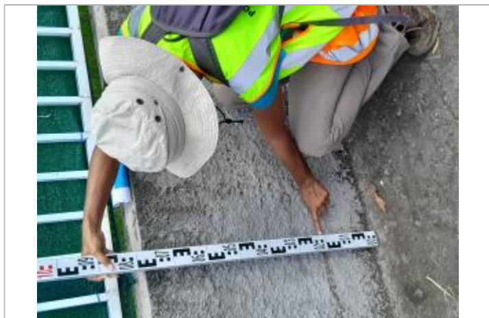
Dépôts de matières solides
