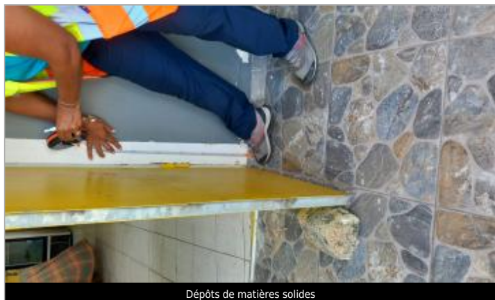
Dépôts de matières solides
