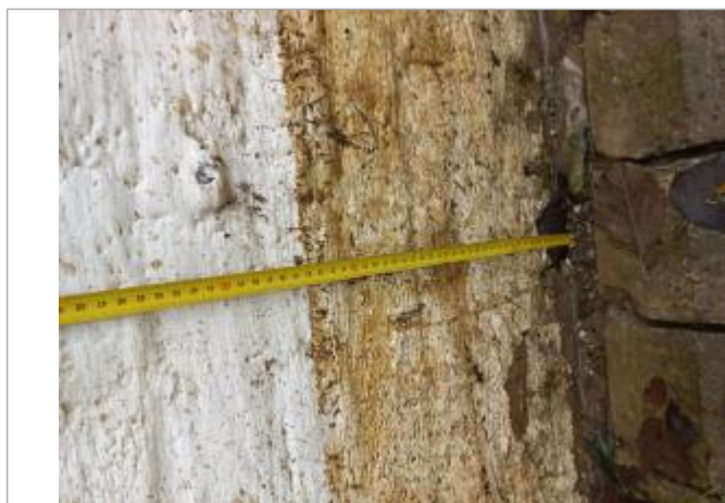
Laisse à 24cm du sol
