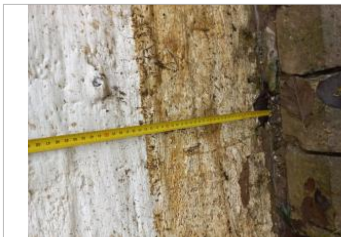
Laisse à 24cm du sol
