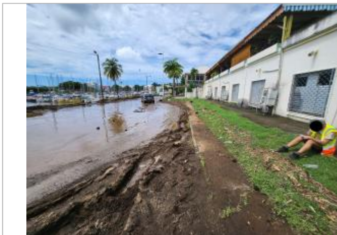
Emprise de zone inondée le long de la RD6
