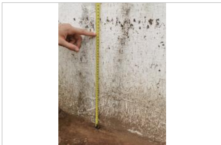
Dépôts de matières solides
