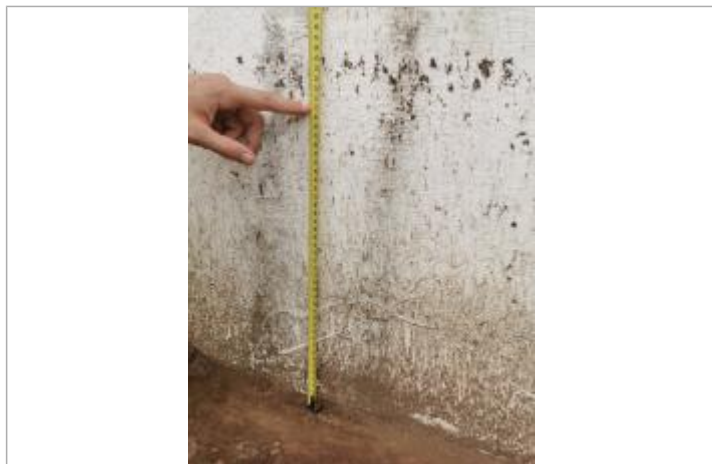
Dépôts de matières solides
