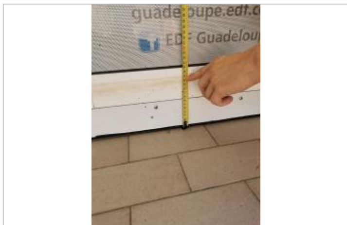
Dépôts de matières solides
