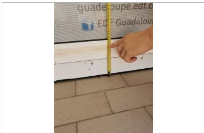
Dépôts de matières solides
