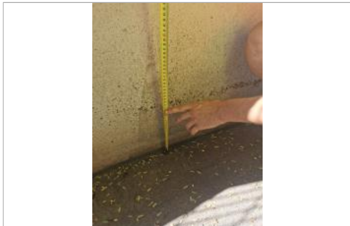
Dépôts de matières solides
