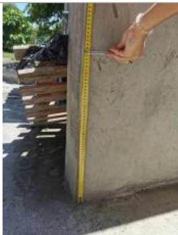
Dépôts de matières solides
