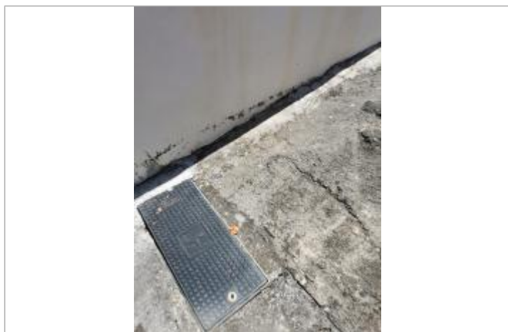
Dépôts de matières solides
