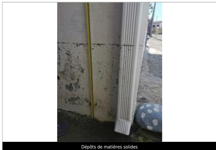
Dépôts de matières solides
