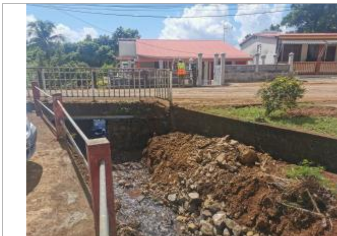
Pont en charge
