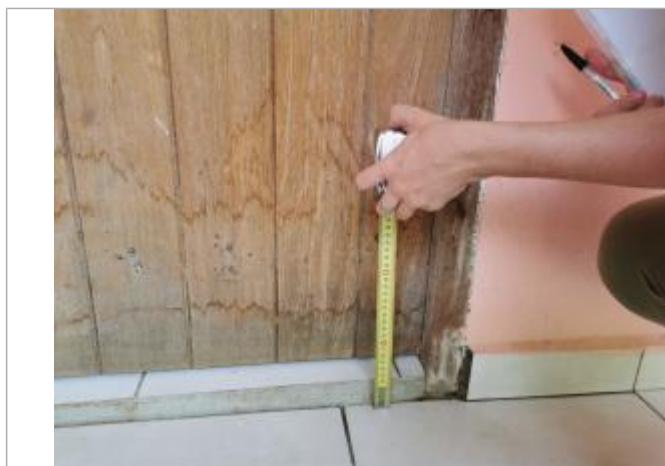
Dépôts de matières solides
