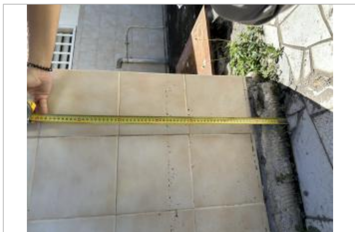
Dépôts de matières solides
