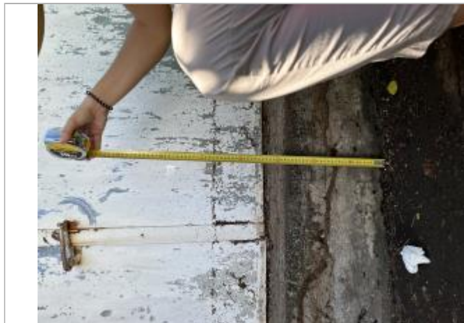
Dépôts de matières solides
