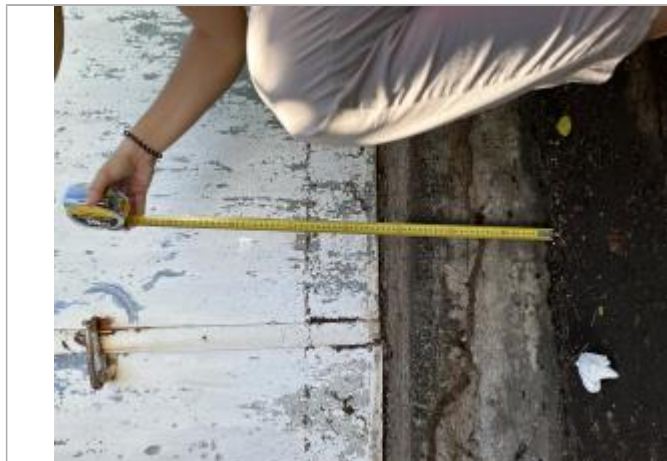
Dépôts de matières solides
