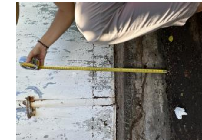
Dépôts de matières solides
