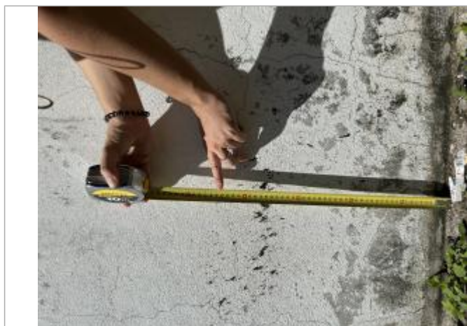
Dépôts de matières solides
