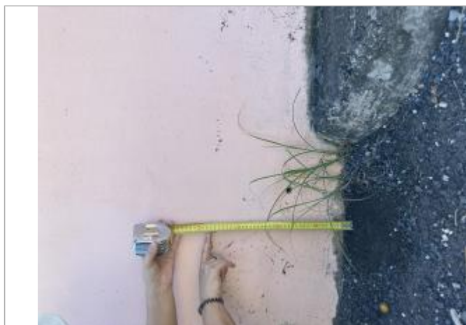
Dépôts de matières solides
