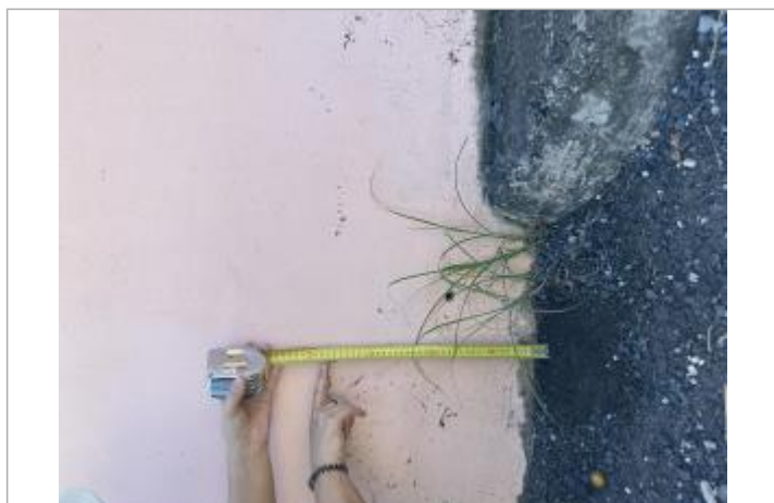
Dépôts de matières solides
