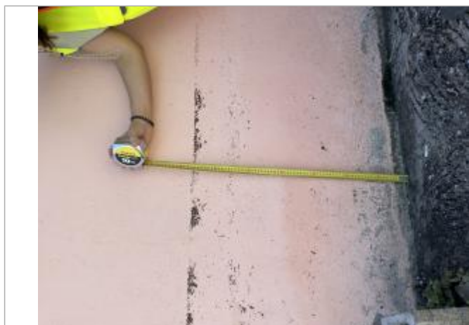
Dépôts de matières solides
