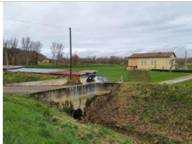
Marque sur structure Photo © AGERIN
