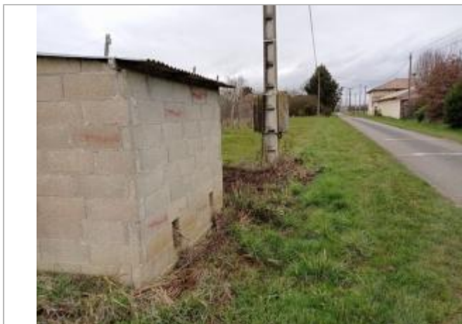
Marque sur structure Photo © AGERIN
