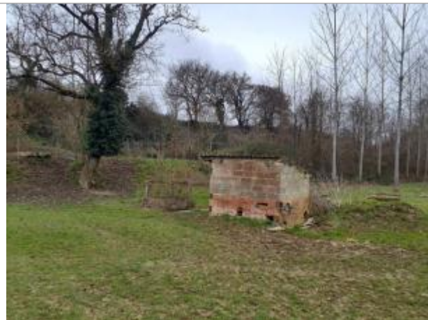
Marque sur structure Photo © AGERIN
