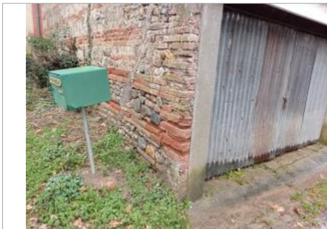
Marque sur structure Photo © AGERIN
