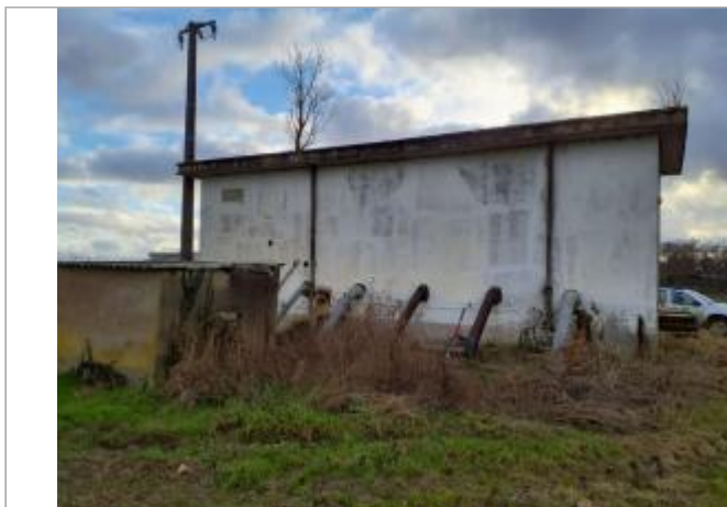
Marque sur structure Photo © AGERIN
