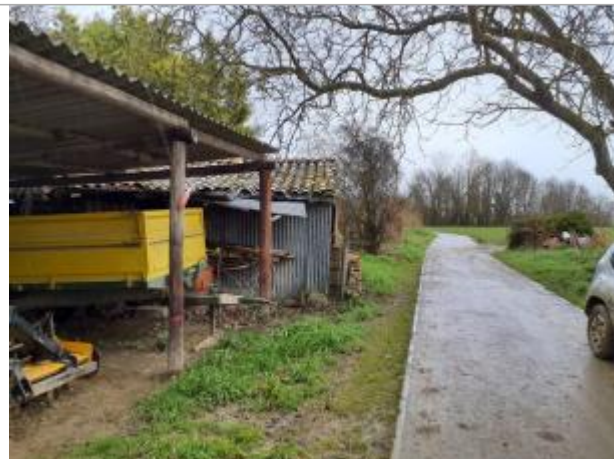
Marque sur structure Photo © AGERIN
