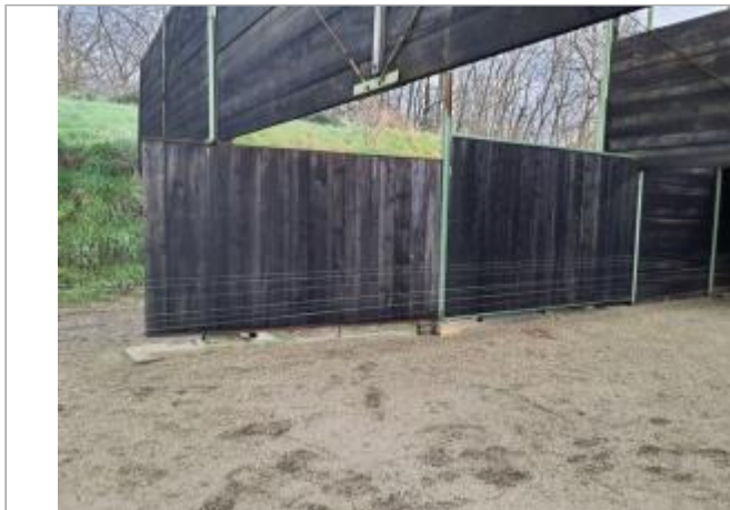
Marque sur structure Photo © AGERIN
