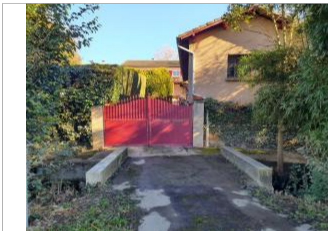
Marque sur structure Photo © AGERIN
