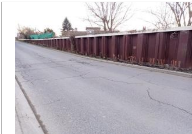
Marque sur structure Photo © AGERIN
