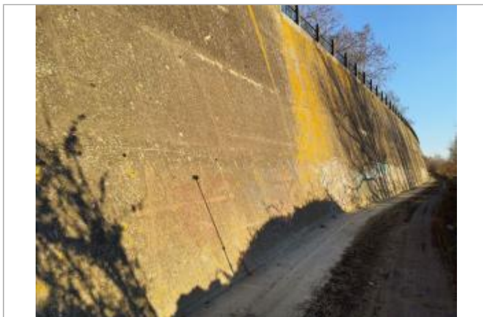
Marque sur structure Photo © AGERIN
