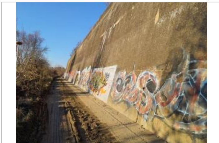
Marque sur structure Photo © AGERIN
