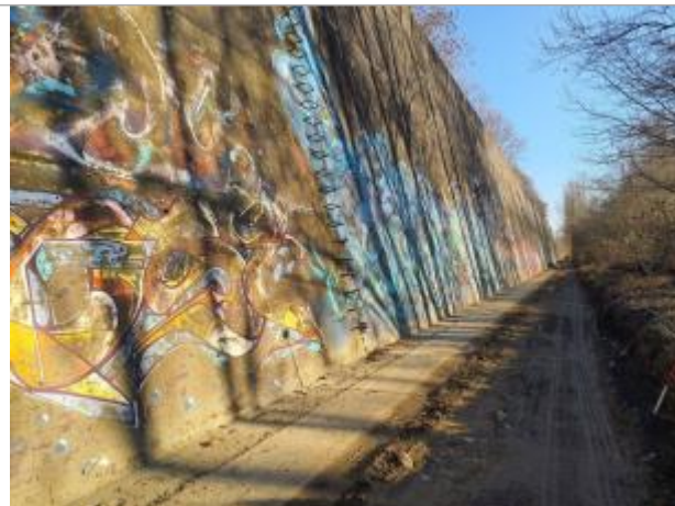
Marque sur structure Photo © AGERIN
