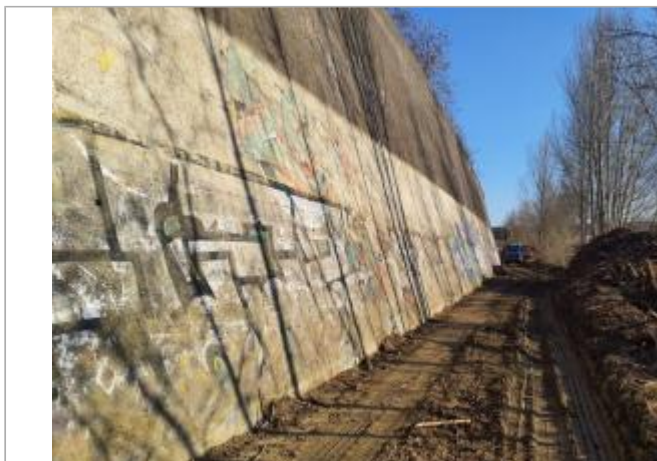
Marque sur structure Photo © AGERIN
