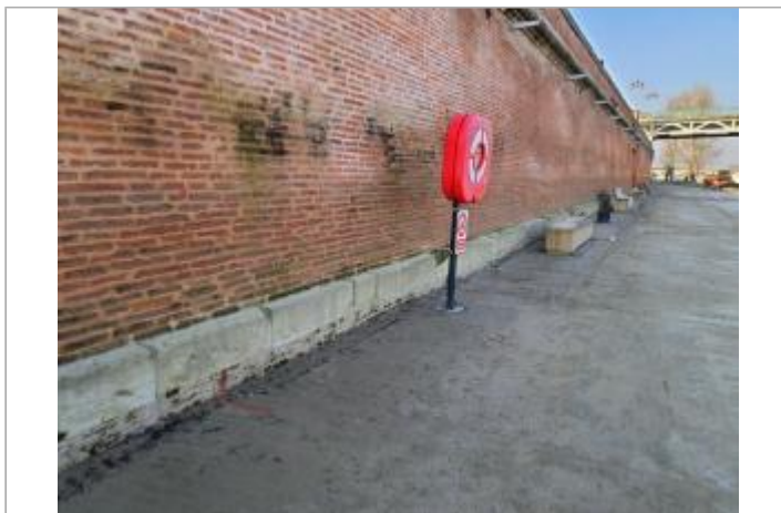
Marque sur structure Photo © AGERIN
