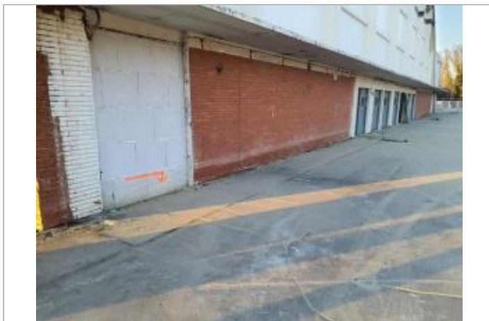
Marque sur structure Photo © AGERIN
