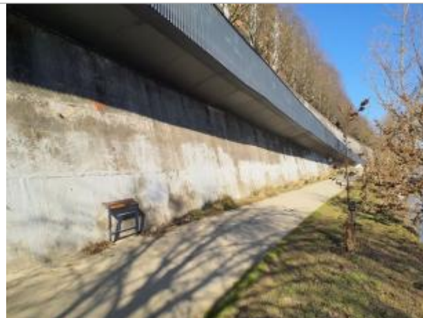
Marque sur structure Photo © AGERIN
