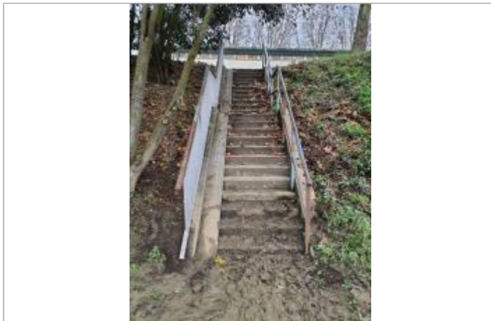
Marque sur structure Photo © AGERIN
