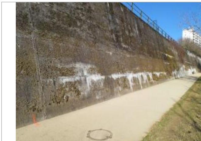
Marque sur structure Photo © AGERIN
