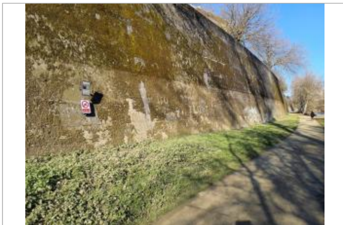
Marque sur structure Photo © AGERIN
