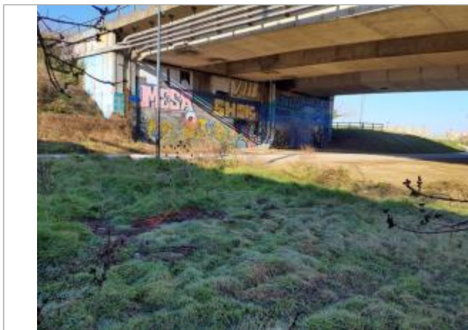
Débris végétaux au sol Photo © AGERIN
