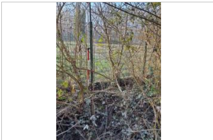
Marque sur structure Photo © AGERIN
